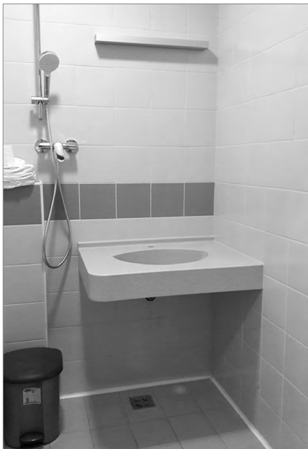
Slika 6: Prenovljena zelo majhna kopalnica tik pred dokončano montažo (manjka pipa). Ob umivalniku je še dodatna pipa za tuširanje za lažjo nego, predvsem oseb na vozičku. V prostoru je na drugi strani še nivojski prostor za tuširanje (foto: Barbara Železnik Bizjak).
