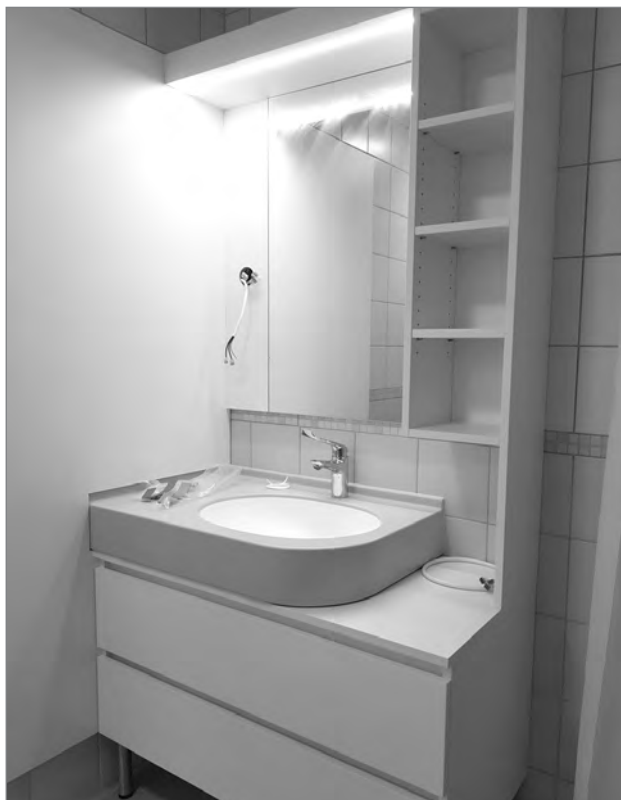
Slika 4: Montaža obloge in omare okrog konzolnega umivalnika, ki je bil prvotno že nameščen v kopalnici. Poseganje v obodni zid ni bilo dovoljeno. Uporabnik je pridobil dovolj odlagalnega in shranjevalnega prostora (foto: Barbara Železnik Bizjak).
