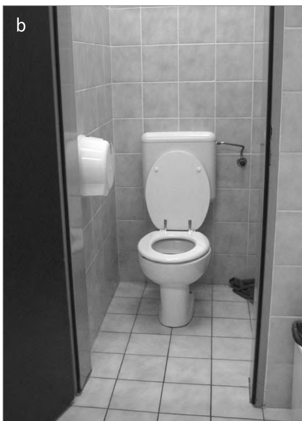
Slika 9: Sanitarni prostori – (a) ustrezen sanitarni prostor za invalide, (b) primer neustreznega sanitarnega prostora (foto: arhiv UIRS)
