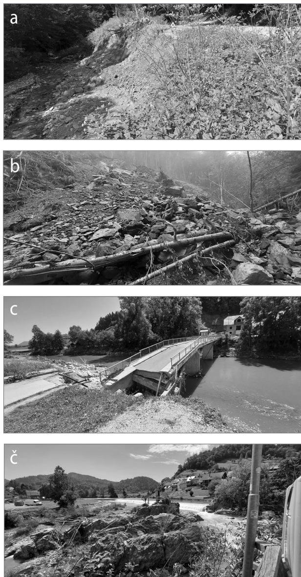
Slika 2: Poškodovane ceste in mostovi: (a) izpodjedena cesta zaradi naraslega hudournika, (b) zasuta gozdna pot zaradi skalnega podora, (c) uničen most čez reko Soro, (č) mesto, na katerem je bila pred poplavo Hudičeva brv (foto: Franc Vidic).
