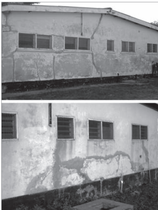
Slika 1: Zadelane razpoke na stavbi v Temi; neprofesionalno vzdrževanje s strani stanovalcev (foto: Laurence Amedzro)
