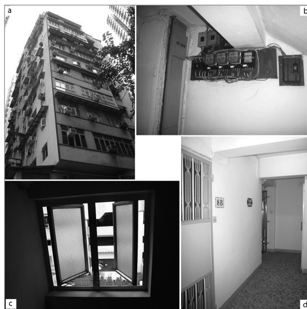
Slika 1: Fizične in higienske razmere v stavbi A; (a) pročelje, (b) električni števec in notranji priključek, (c) stopniščno okno v dobrem stanju, (d) skupni hodnik (foto: Yung Yau).
