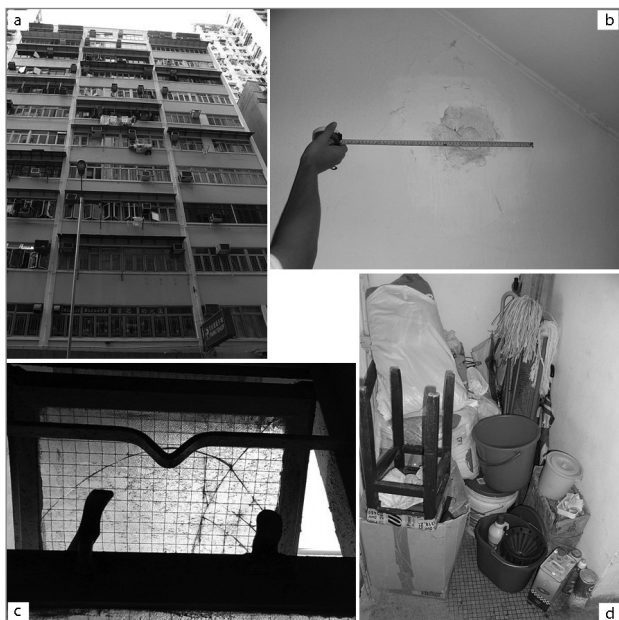
Slika 2: Fizične in higienske razmere v stavbi B; (a) pročelje, (b) krušenje zidu na stopnišču, (c) počeno steklo v stopniščnem oknu, (d) razni predmeti pod stopniščem (foto: Yung Yau).
